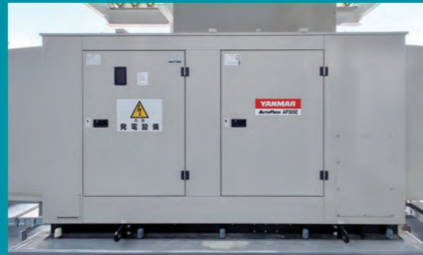
▲非常用発電設備
