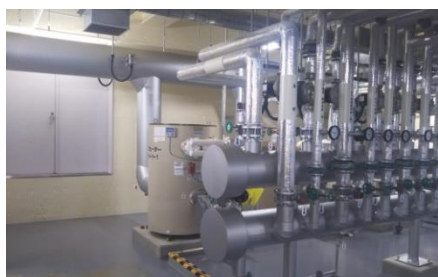
【余裕のある機械室（岩内町役場）】
